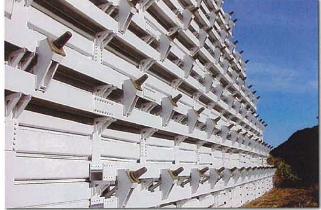
【のり面補強鋼材の防錆】
