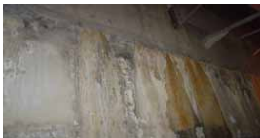
施工前(地下室の打継からの漏水)
