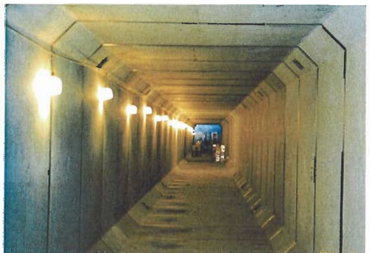
関西国際空港高松高架橋下部工共同溝目地コーキング
